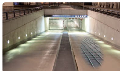
Rampa de acceso a garaje calefactada.
